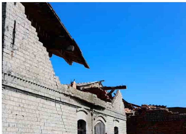
Budynki gospodarcze zostały kompletnie zniszczone.
