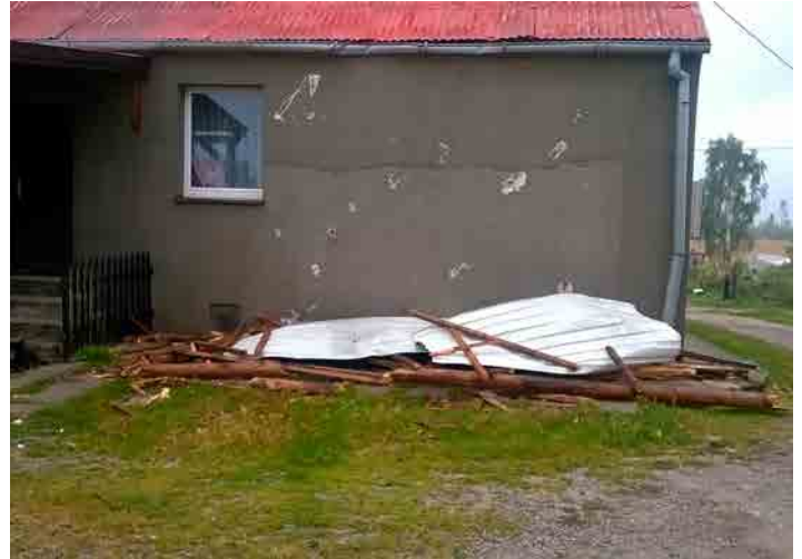
Elementy z uszkodzonych budynków gospodarczych leciały w kierunku domu Państwa Zygmąskich.
