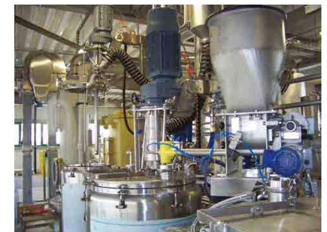
Instalacja granulacji nawozów – węzeł przygotowania pulpy nawozowych
